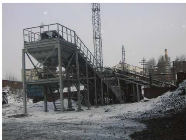
Установка для отсева коксовой мелочи доменного цеха на промышленной площадке доменного цеха
