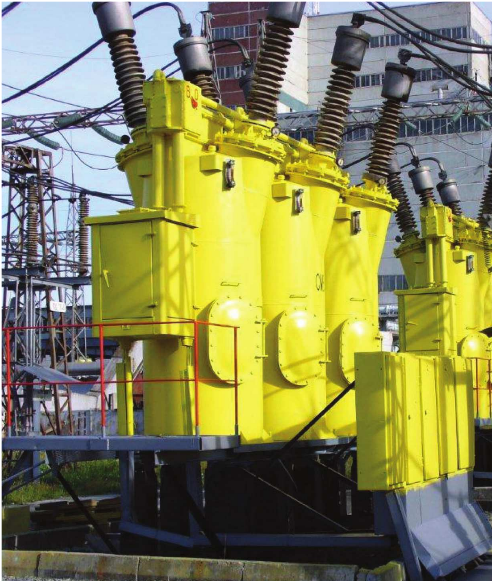
Организация: ООО ПП «Волкомпани» Объект: Трансформатор, Новосвердловская ТЭЦ, г. Екатеринбург
