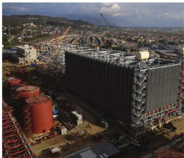
Сухая вентиляторная градирня. Адлерская ТЭС.
