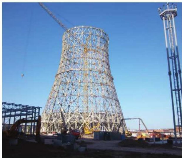
Башенная испарительная градирня. Энергоблок ПГУ-410Т
